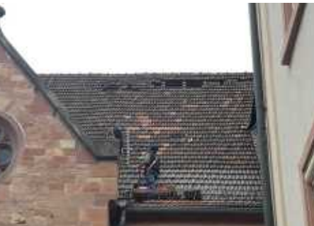
Dachschaden nach Sturm
